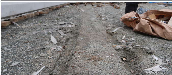
연약지반 시공시 부등침하에 따른 하자발생 (황만곡)
