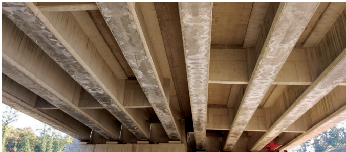
노후 각재 사용에 의한 굴곡 발생
