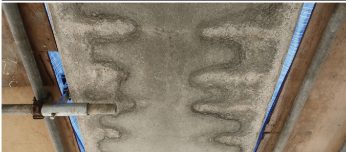
노후 각재 사용에 의한 굴곡 발생
